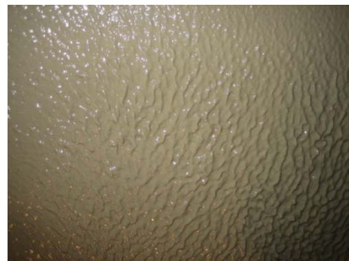
„Orangerhautstruktur“ im Deckenbereich
