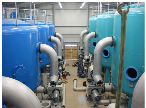
Filterkessel, Rohrleitungskombination - Edelstahl u. PP
