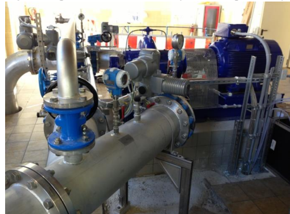
Pumpe als Turbine im Zulauf der Reinwasserbehälter
