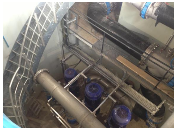
RW-Pumpen im ehemaligen Saugschacht, neu: Treppe
