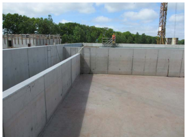
Tos- und Absetzbecken für Spülschlammwasser
