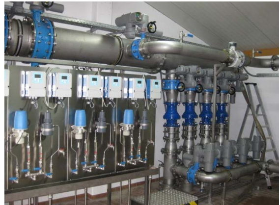
Oben: Förderleitung DN 400, unten: Infiltrationsleitung
