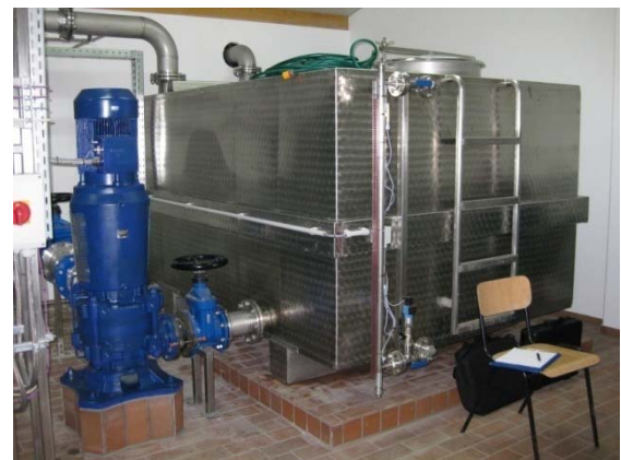
Infiltrationspumpe und Entgasungsbehälter
