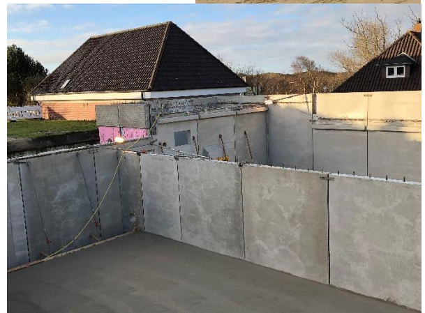
oben: Mittelwand vorne rechts, hinten Rw.-Pumpenhaus
