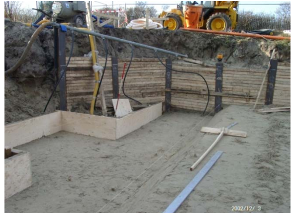
Vorbereitung Baugrube mit Grundwasserabsicherung und Verbau zur Baugrubensicherung; Sohl-Schalung Sohle und Planum vorbereitet
