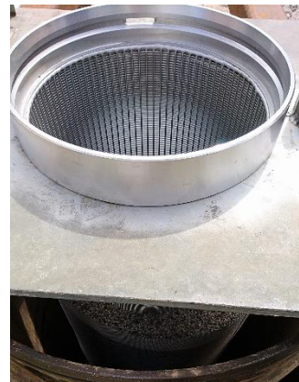
Einbau Wickeldrahtfilter auf Abfangschelle inkl. Befüllung der Kieskörbe zur Herstellung der inneren Kiesschüttung (Filterkies Ø 3,0 – 5,6 mm)
