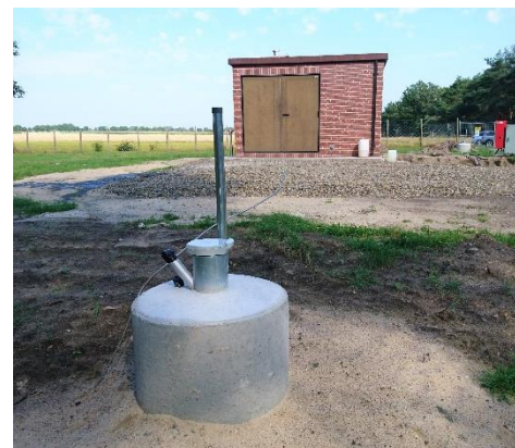
Grundwassermessstelle DN 115 und fertige Brunnenstation Br. VIII.2
