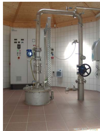
Brunnenstation mit technischer Ausrüstung
