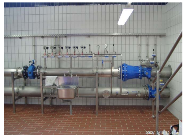
Rohrleitungsanlagen mit Ein- und Ausgangsleitungen
