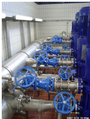
Saug- und Druckstutzen der Pumpen
