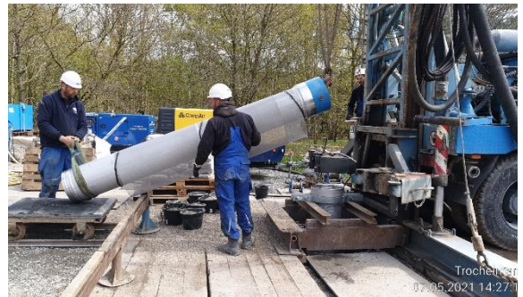
Einbau Wickeldrahtfilter inkl. Befüllung der Kieskörbe zur Herstellung der inneren Kiesschüttung (Filterkies Ø 3,15 – 5,6 mm)
