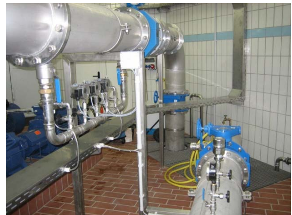
Rohrleitungsanlagen im Zu- und Ablauf
