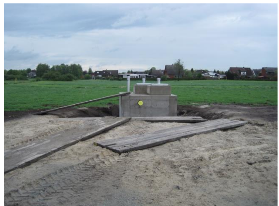
Brunnenschacht mit technischer Ausrüstung, später mit Bodenüberdeckung und flach geneigter Böschung
